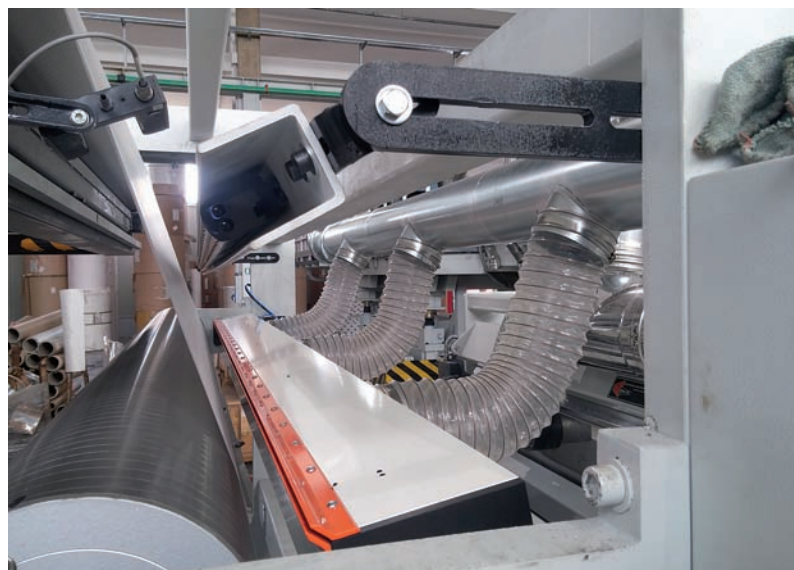
Abb. 1: Das Entstaubungssystem Xstream in einer Folienkaschierungsanlage mit der Arbeitsbreite von 2600 mm.
